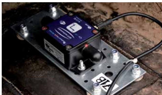
Fot. 9. Zdjęcie zastosowanych inklinometrów firmy BeanAir.
