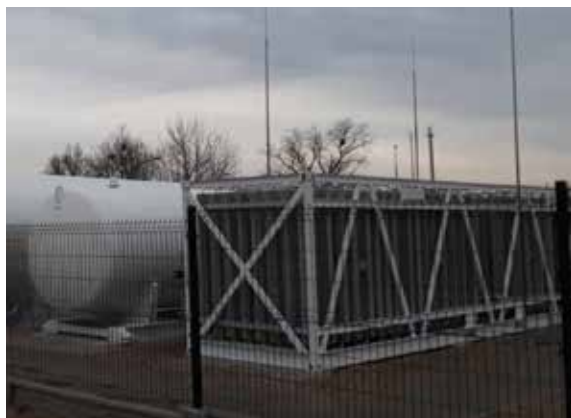
Rysunek 4. Przewoźna stacja regazyfikacji LNG
