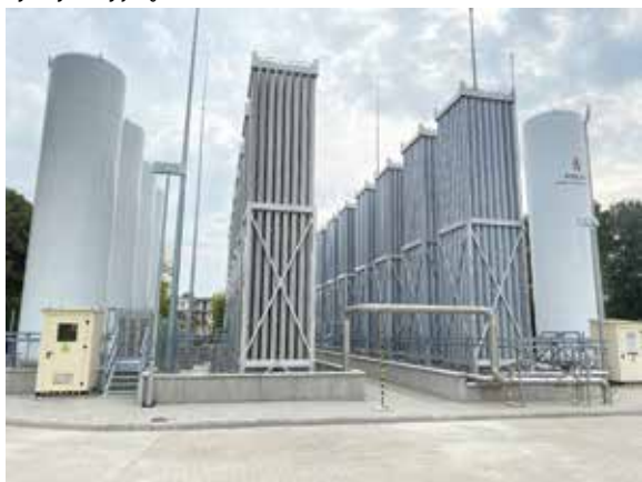
Rysunek 8. Stacja regazyfikacji LNG dosilająca sieć dystrybucyjną
