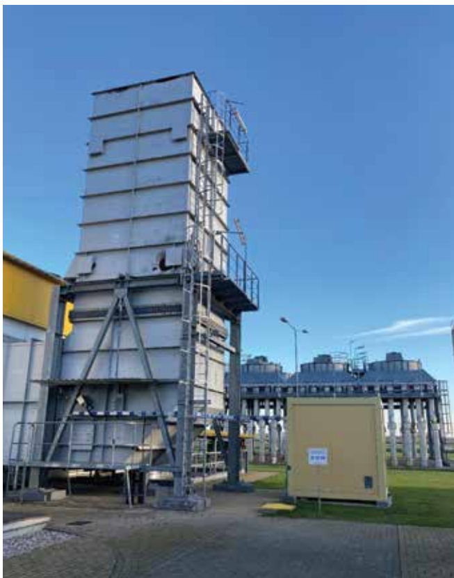
Kanał wylotowy spalin turbiny GT-10B – umiejscowienie punktu poboru, trasy przewodu przesyłającego próbkę do analizatora oraz kontener analizatorów.
