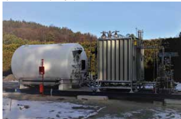
Rysunek 5. Stacja regazyfikacji ze zbiornikiem do 10 m 3
