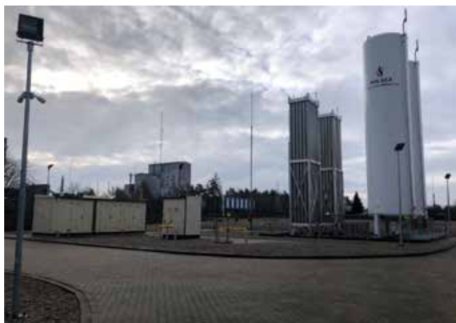
Zdjęcie 1. Przykładowa stacja regazyfikacji LNG.
