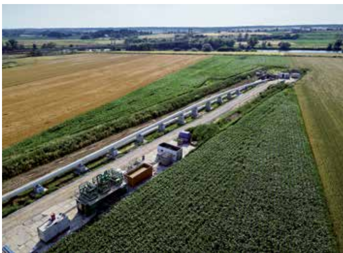
Przewiert metodą MTS SYSTEM 2 pod Odrą w Kątach Opolskich na odcinku II na terenie Oddziału w Świerklanach.
