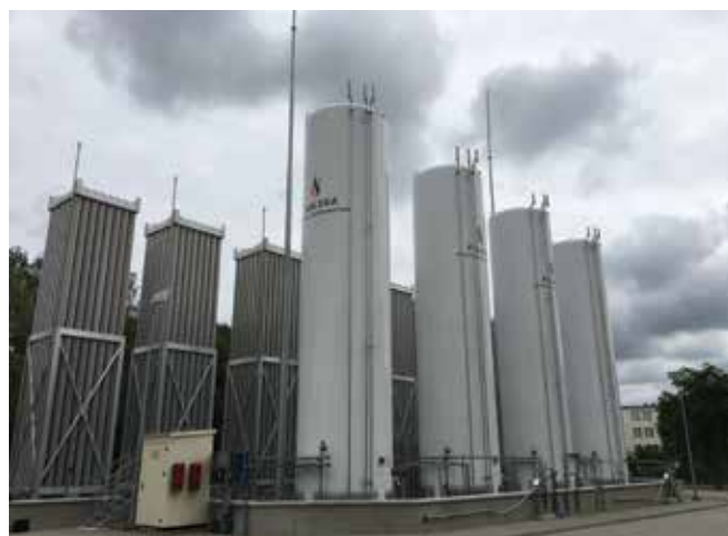
Zdjęcie 5. Stacja regazyfikacji LNG dosilająca system dystrybucyjny.
