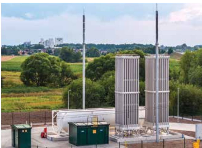
Zdjęcie 2. Stacja regazyfikacji LNG z zbiornikiem poziomym.
