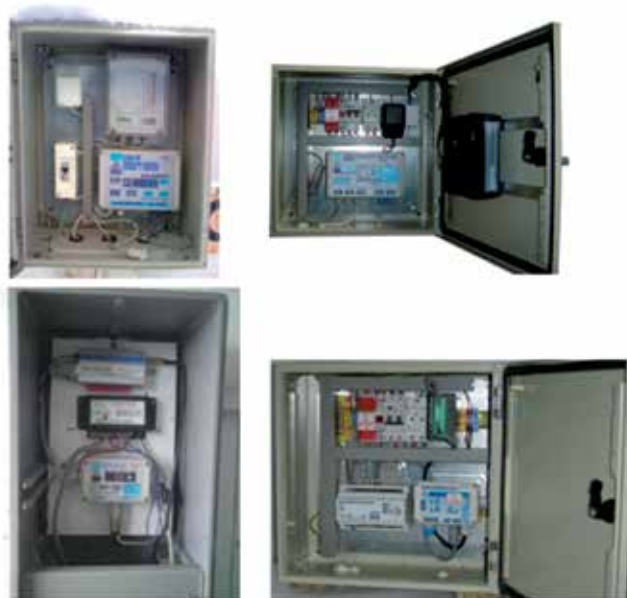
Przykładowe zdjęcia szafek telemetrii stosowanych na małych obiektach gazowniczych (zdjęcie pochodzi z dokumentacji firmy COMMON).
