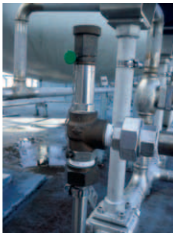
Zdjęcie 3. Zabezpieczenie zamkniętego fragmentu orurowania wydmuchowymi zaworami bezpieczeństwa.
