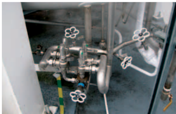
Zdjęcie 2. Dwie pary wydmuchowych zaworów bezpieczeństwa przy zbiorniku.
