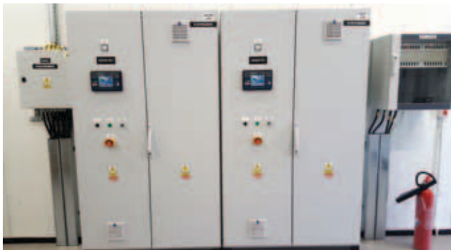
Rys. 3. Sterownia agregatów prądotwórczych
