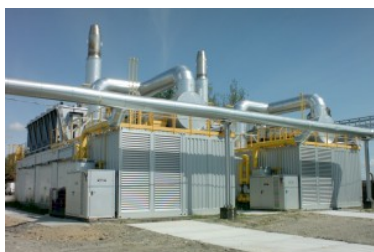
Układ kogeneracyjny w Chudowie na Śląsku zasilany metanem z pokładów kopalni Budryk. Fot. PTWP (Andrzej Wawok)
