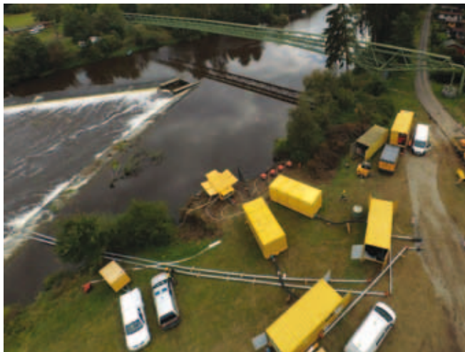
Rysunek 3. Komora nadania tłoka oraz zestaw pomp i zbiorników
