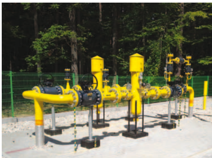
Infrastruktura techniczna stacji w Aleksandrii.
