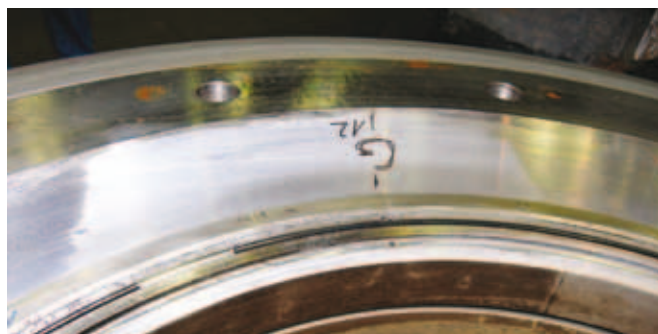
Zerwanie uszczelki głównej w DN 900 na godz. 11.00.
