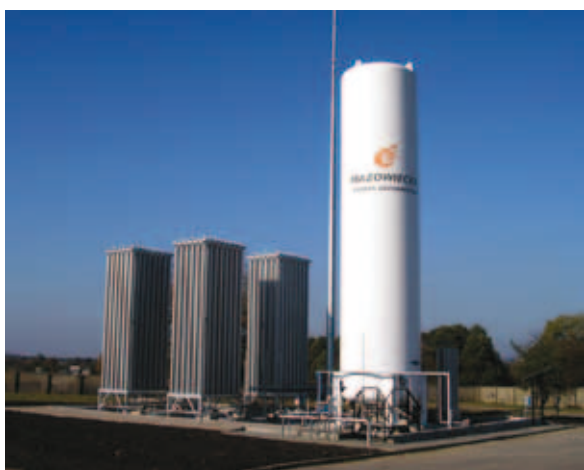
Stacja regazyfikacji LNG.
