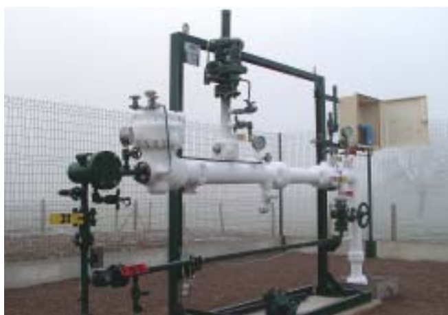
Fot. 1. Widok zewnętrzny przykładowej stacji gazowej pracującej w trybie zimnej redukcji we Francji. Źródło archiwum Emerpol Sp. z o.o.
