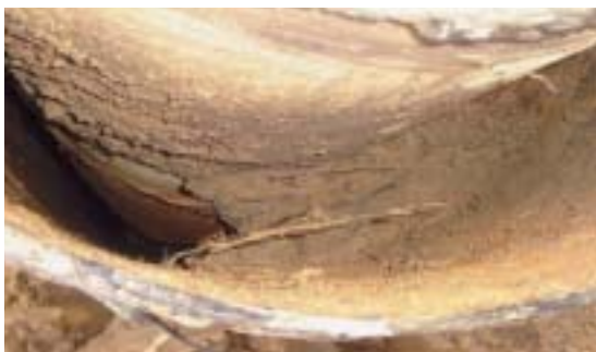
Rys. 1. Wnętrze rury ochronnej, widoczne ślady korozji i zdegradowanej izolacji.
