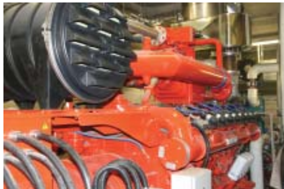
Agregat kogeneracyjny na gaz ziemny.
