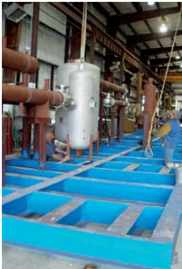
Montaż elementów stacji skraplania w modułach przygotowanych do transportu kontenerowego („skid”) w hali produkcyjnej firmy Kryopak w Stanie Teksas, USA.
