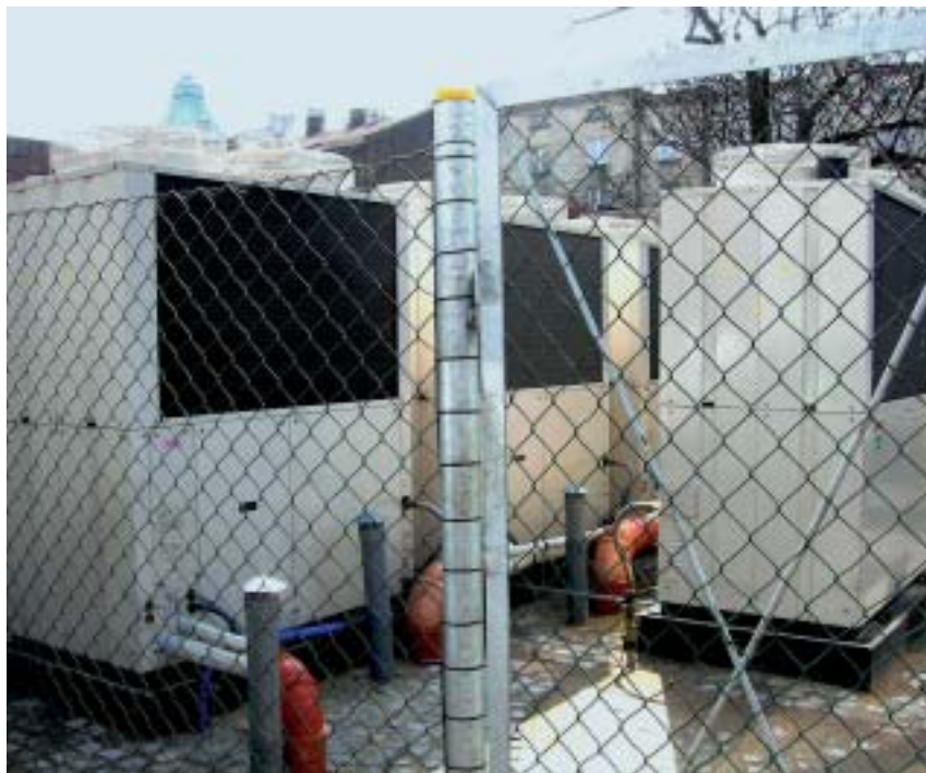
Fot. 3. Gazowe pompy ciepła.
