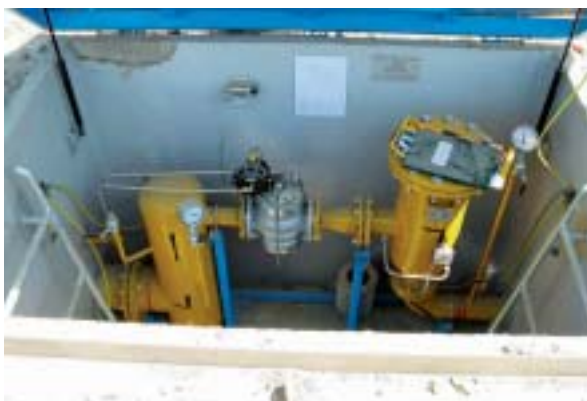
Widok wnętrza niedużej stacji jednociągowej
