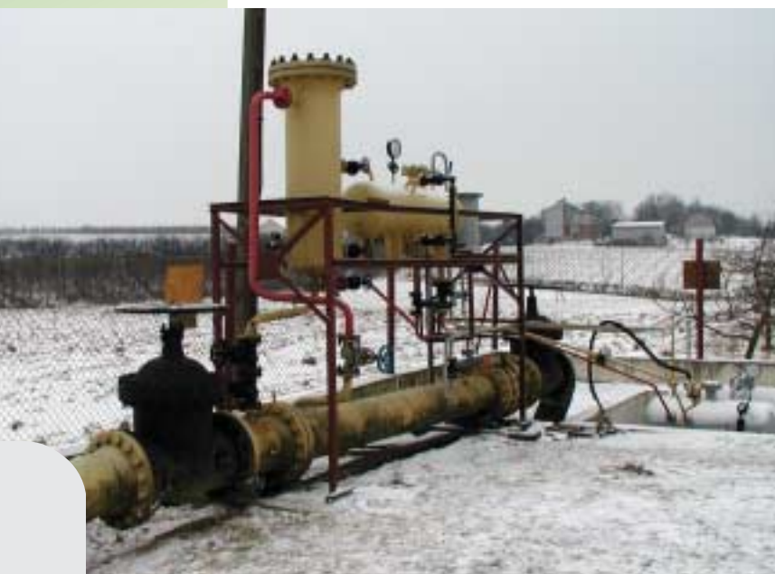
Nawalalnia gazu przy stacji redukcyjno-pomiarowej I stopnia w Suchedniowie.
