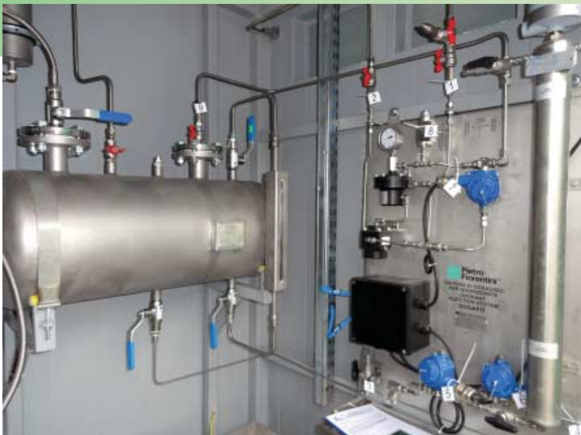
Panel sterujący wraz ze zbiornikiem THT w nawianalni przy stacji redukcyjno-pomiarowej I stopnia w Skarżysku Kamiennej, os. Rejów.
