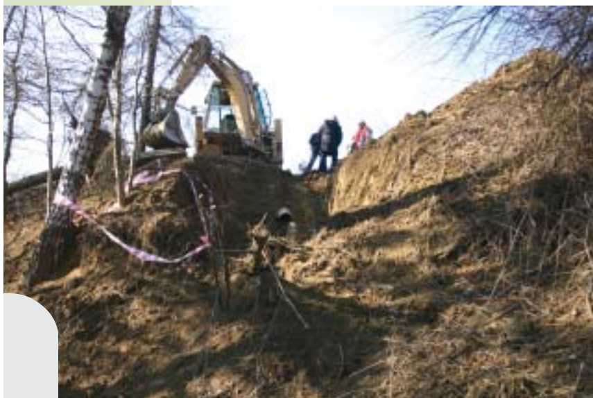
Uszkodzony gazociąg w wyrwie powstałej wskutek osuwiska.
