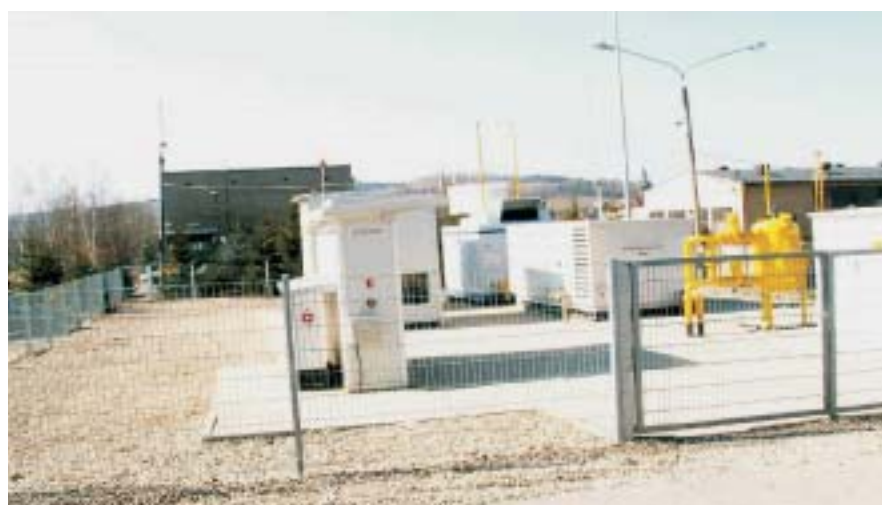
Stacja CNG w Wałbrzychu przy ul. Ludowej ma znaczne obciążenie mocy.
