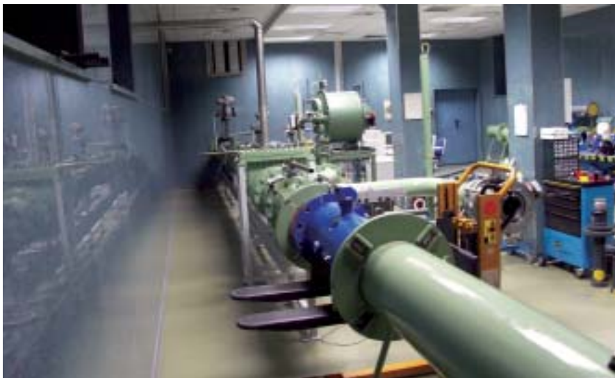
Stanowisko CLPB do wzorcowania gazomierzy turbinowych.
