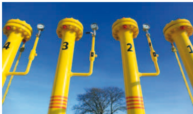
Wężel przesyłu gazu w Reszkach.
