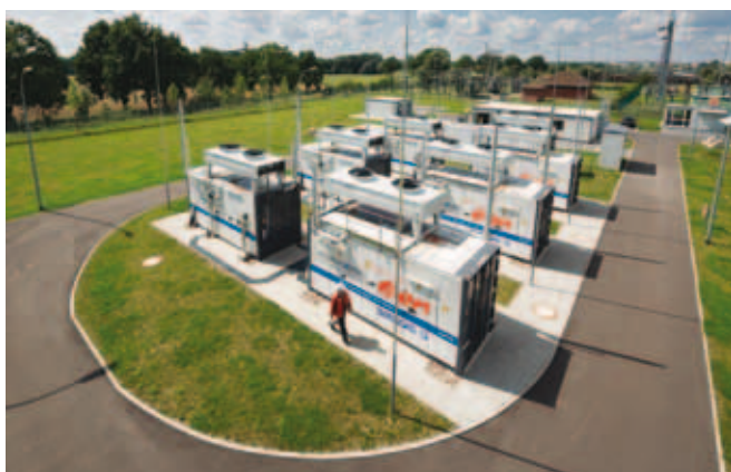
Fot. 1. Instalacja elektrolizerów w Falkenhagen, Niemcy (źr. E.ON).
